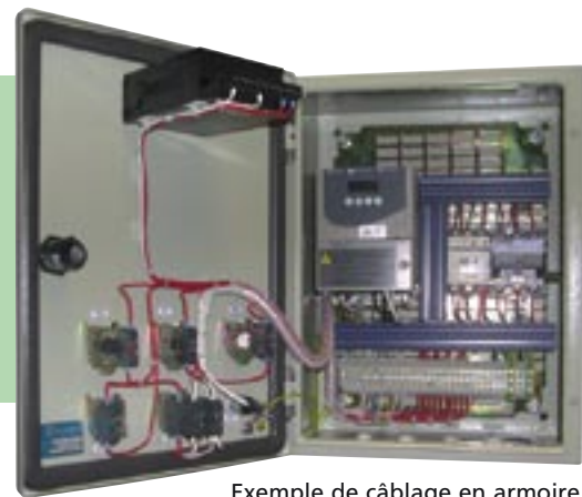
Exemple de câblage en armoire
